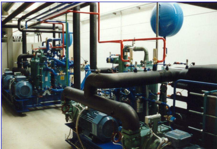
Maschinenraum einer indirekten NH 3 -Anlage eines Großmarktes.
